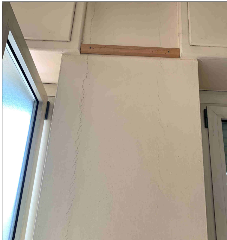
Fessura nella muratura di ricoprimento di un pilastro
